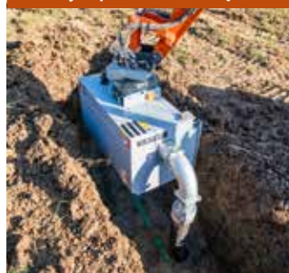
Wykop: Szufłada ssąca
